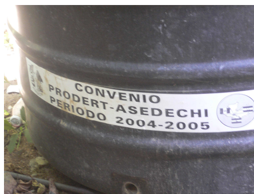
Figura 20. Tanque del sistema.
