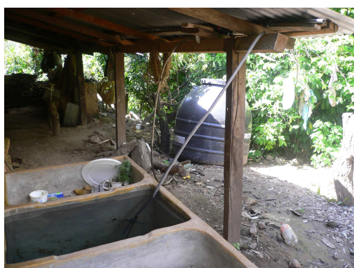
Figura 19. Tanque del sistema de minirriego bandonado debajo de la casa de un beneficiado.
