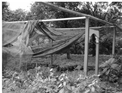
FIGURA 27. Vista del vivero deteriorado.
