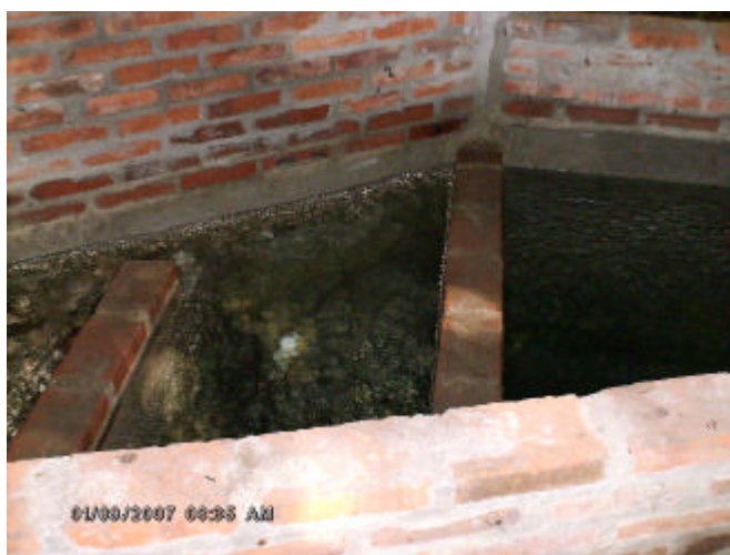
Figura 2.6 Filtro artesanal construido para el manantial de la finca Sabanetas.
