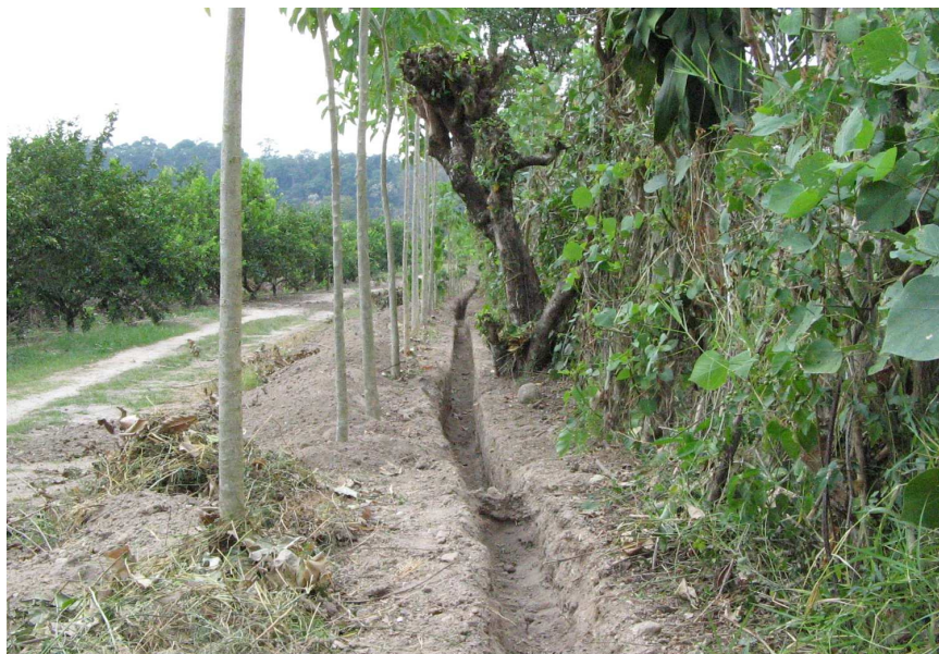
Figura 32. Canal de captación y desviación de agua superficial
