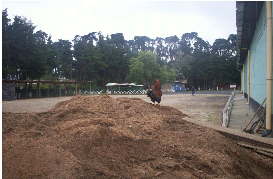
Figura 60 Movimiento de tierra para la ejecución de mejoras en el área de parqueo número dos.
