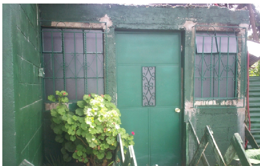
Figura: 11 Instalaciones sanitarias actuales de la bodega INDECA Chimaltenango
