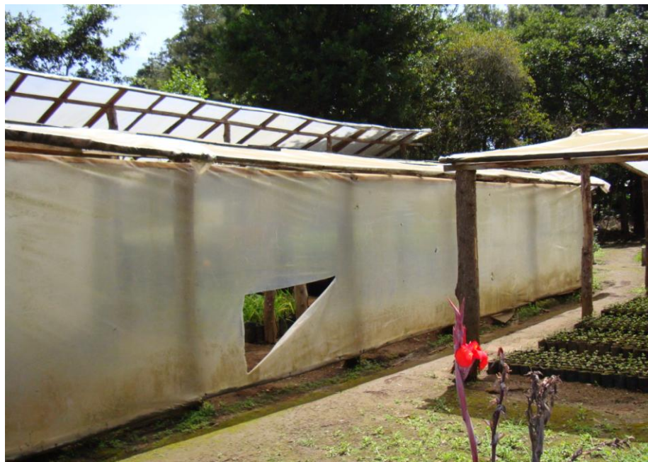
Figura 3.14 estado del invernadero antes de repararlo
