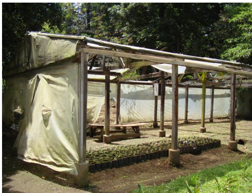
Figura 3.15 estado del invernadero antes de arreglarlo
