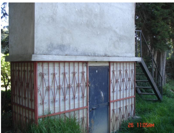
Figura 23 Pozo mecánico No. 1
