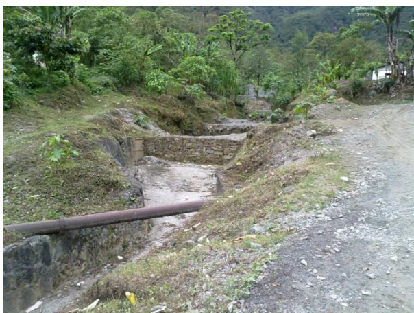
Figura 13 Situación actual de los gaviones, que es necesario dragar la arena.
