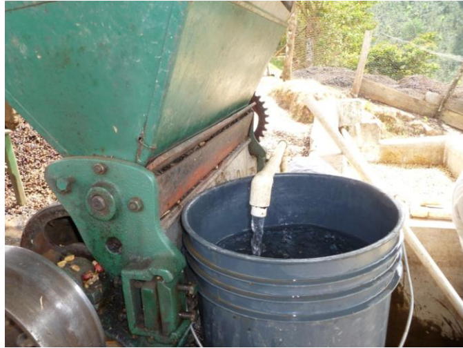
Figura 23. Tubería ubicada en el despulpador.
