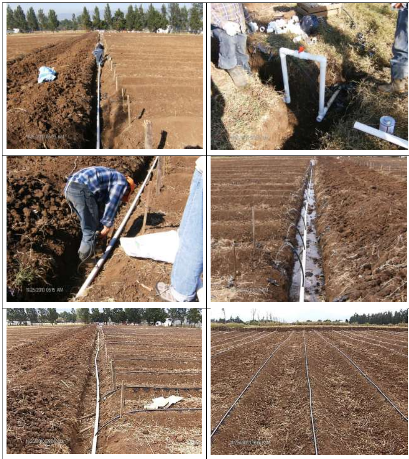
Figura 45. En las imágenes se puede apreciar lo siguiente: A y B) zanjeo y colocación de tubería. C) Perforación de tubería de pvc a 1.20 metros entre sí. D) Colocación de elevadores. E y F) Colocación de cinta de manguera de riego por goteo. Fotos de Walter Herrera, 2010.
