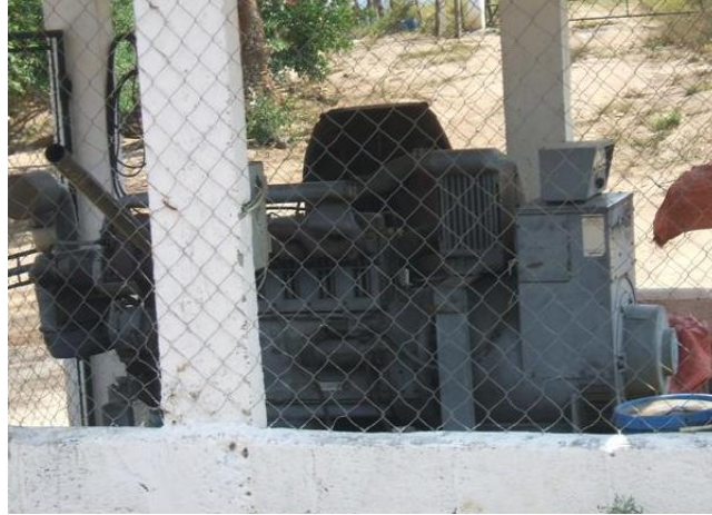
Figura 2 planta de generación de energía eléctrica utilizada para el funcionamiento del beneficio.
