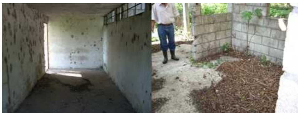
Figura 35. Vista de la vivienda abandonada
