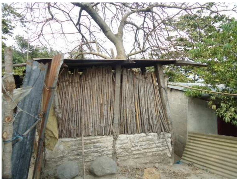
Figura 12. Situación actual de la vivienda, San Antonio Chacayá, Santiago, Atitlán, Sololá
