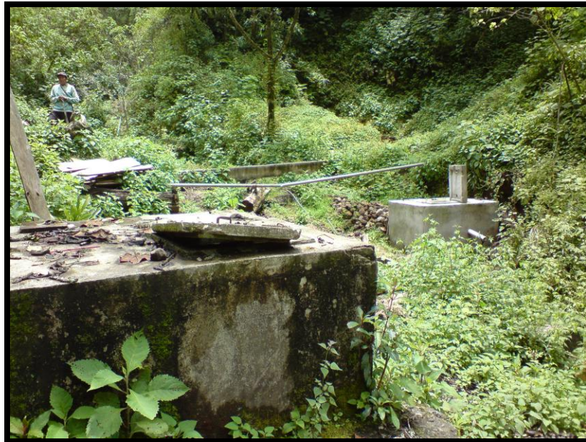
Figura 14. Cajas de Captación
