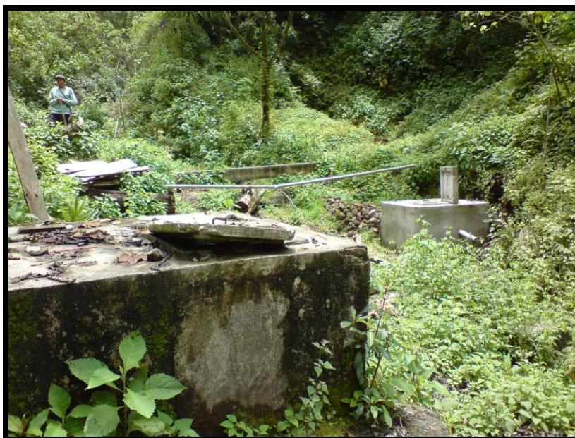
Figura 7A. Cajas de captación
