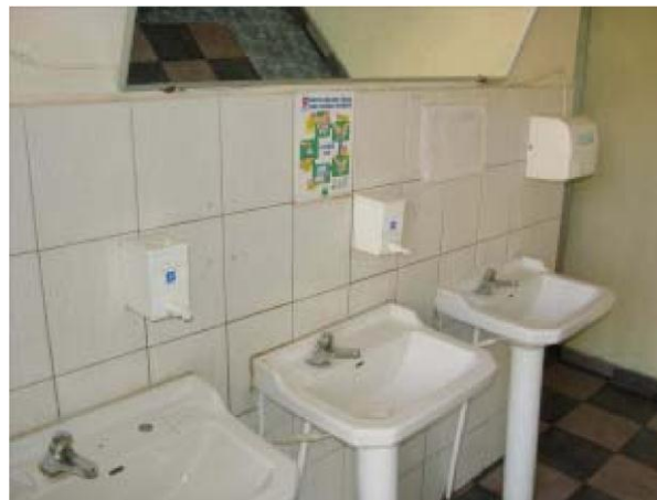
Figura 5. Unidad sanitaria para el lavado de manos.
