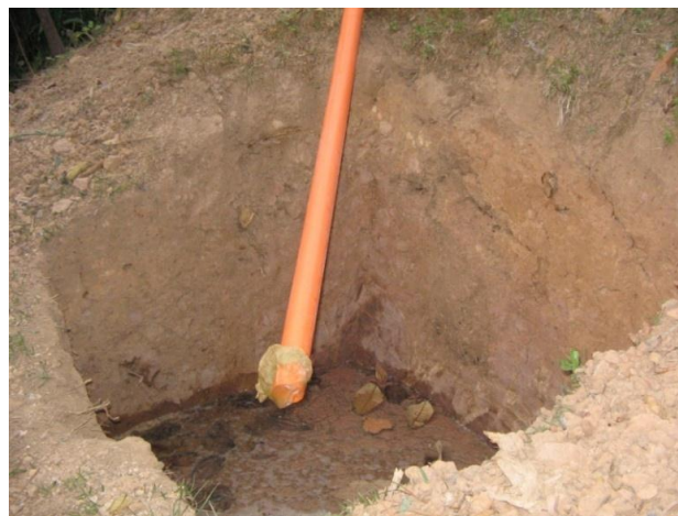
Figura 33. Fosa para la captación de aguas mieles.
