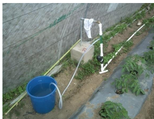
Figura 62A. Sistema Ventury en funcionamiento.
