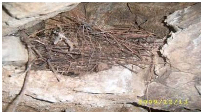
Figura 41. Nido de ave, en grieta de manantial de agua
