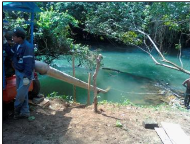
Figura 34. Tubería para el abastecimiento de agua a la bomba
