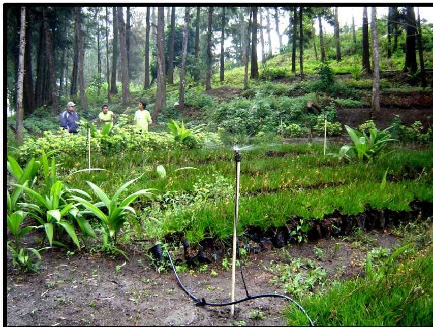
Figura 56. Aspersores gironet en área de ornamentales con riego por aspersión reparados.
