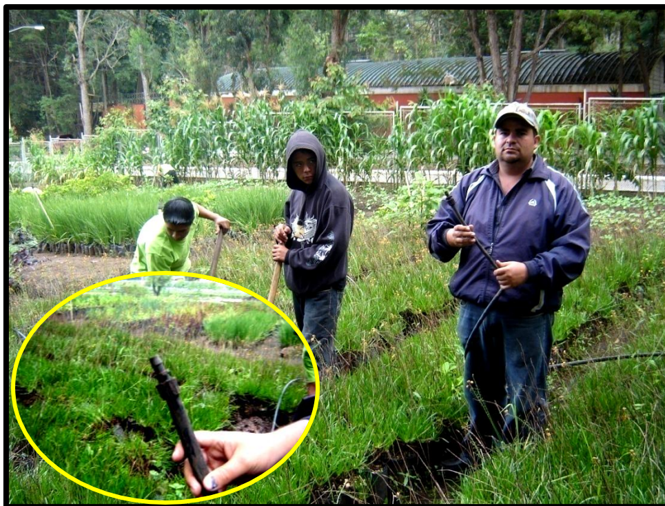
Figura 54. Adaptadores poliducto utilizados para conectar los aspersores a la tubería en el nuevo sistema de riego.
