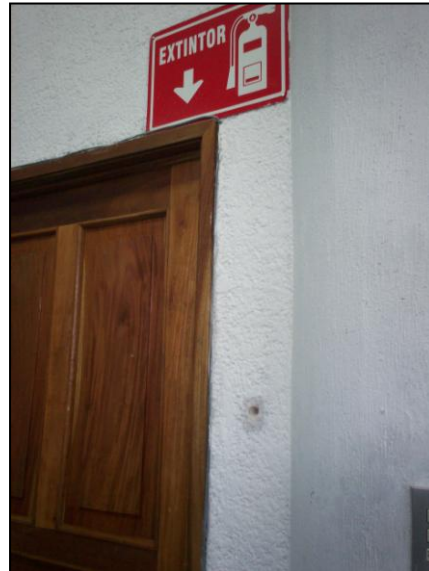
Figura 50. Áreas sin extintores
