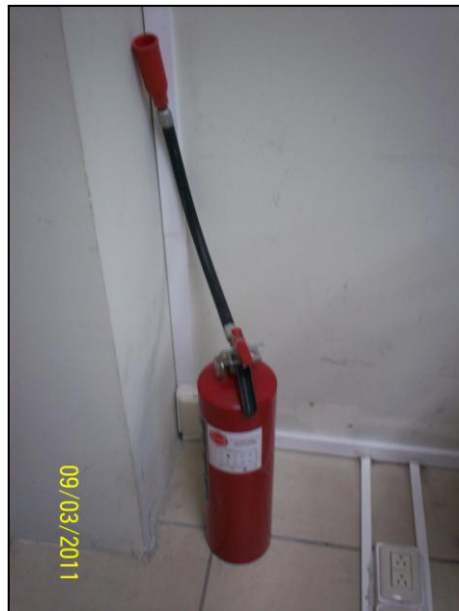
Figura 49. Extintores mal ubicados
