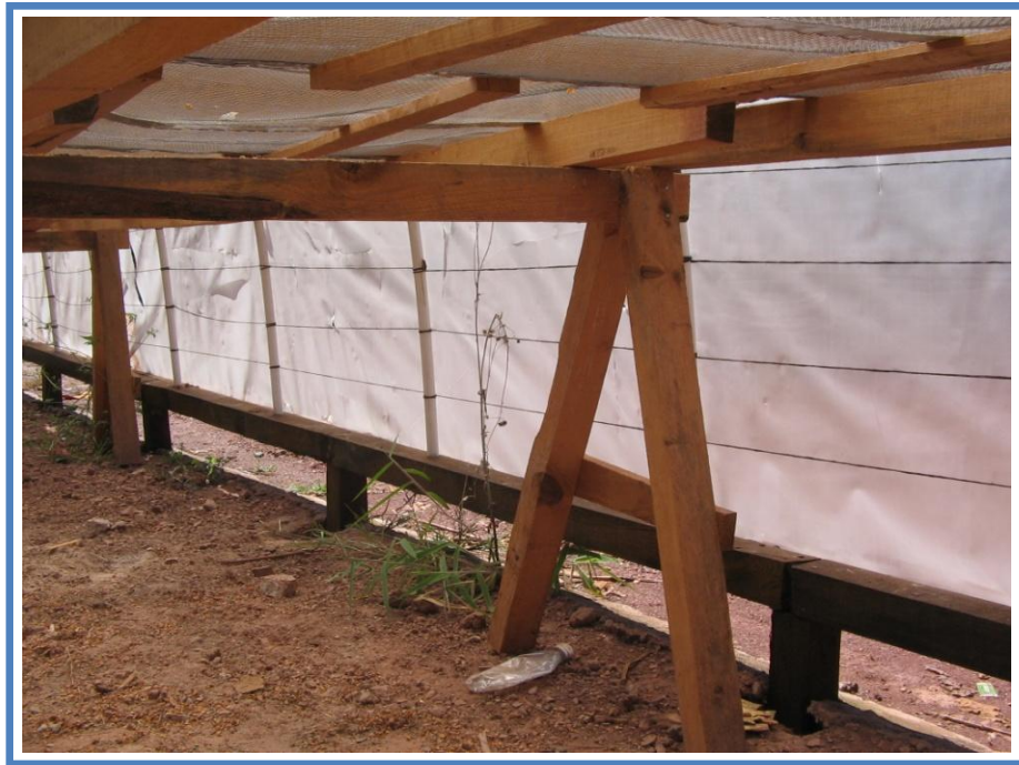
Figura 23 Entradas inferiores de aire frío.
