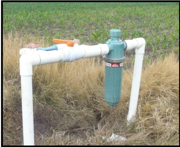
Figura 18 Filtro en sistema de riego por goteo
