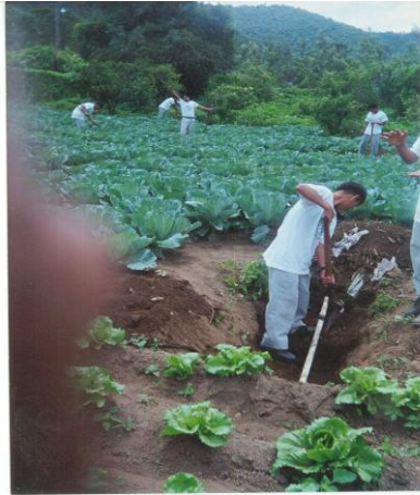
Figura 7 Instalación de chorro para abastecimiento de agua para riego.
