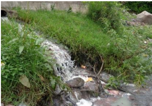
Figura 36 Drenaje en Bárcenas. Fuente: Sofia Ibañez
