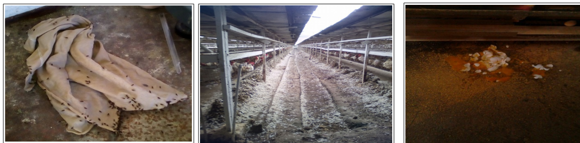
Figura 11. Suciedad presente en las instalaciones
