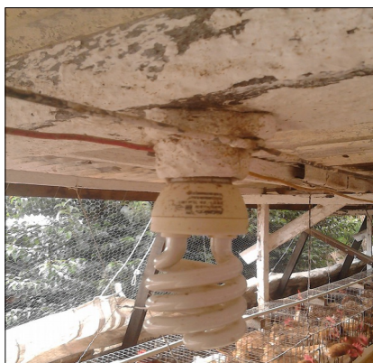
Figura 63. Luminarias en galeras que presentan suciedad y sin función
