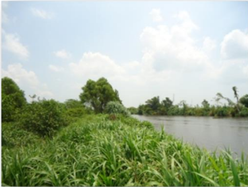
Foto 5. Bordas ejecutadas en Aldea Santa Odilia, sobre el río Coyolate. Fuente: ICC.
