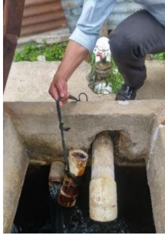
Figura 25. Fotografía del sistema de cloración en pastillas
