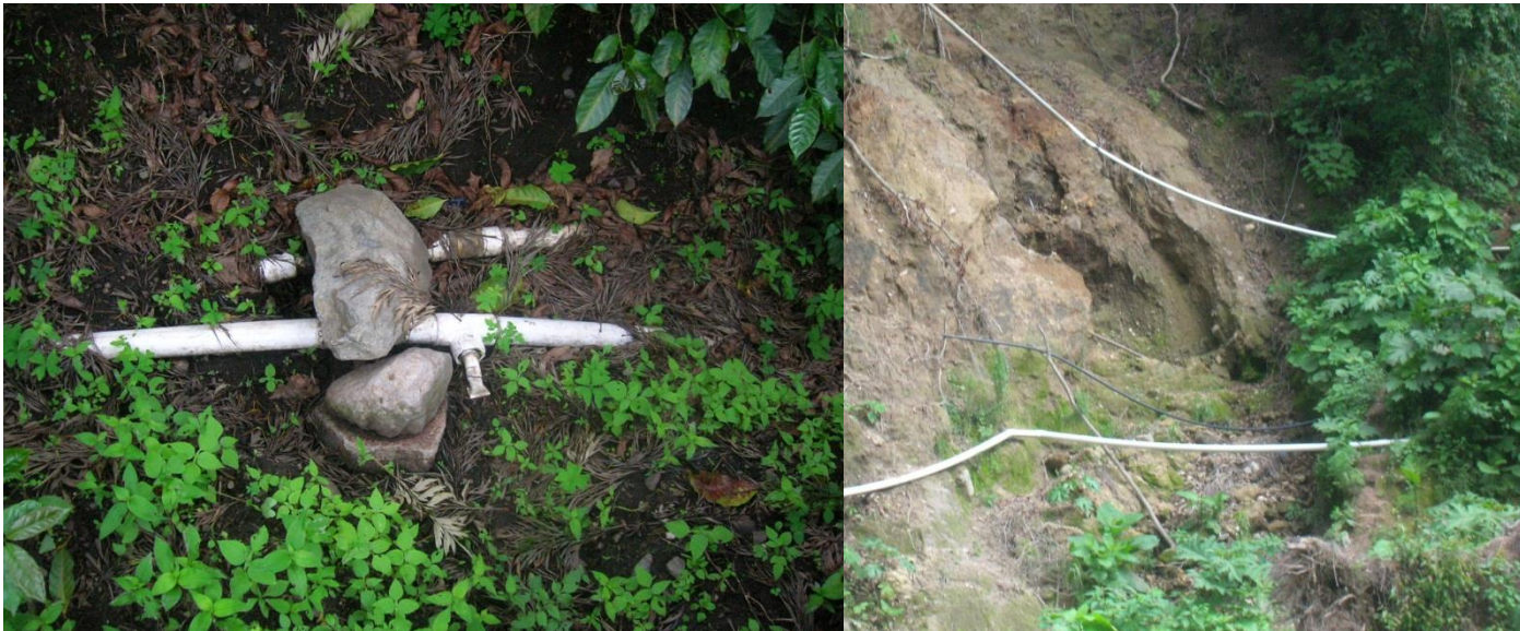
Figura 16A. Deficiente sistema de tuberías para distribución de agua entubada.
