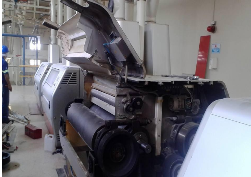
Imagen No. 15. Interior de la tolva de recogida
