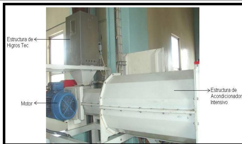
Imagen 1. Acondicionador intensivo ubicado en el sexto nivel.
