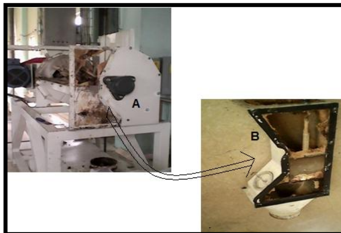
Imagen 2. A) Se observa el lugar de donde fue retirada la recámara que se observa en la figura B. B) recámara de salida de producto rociado con agua.
