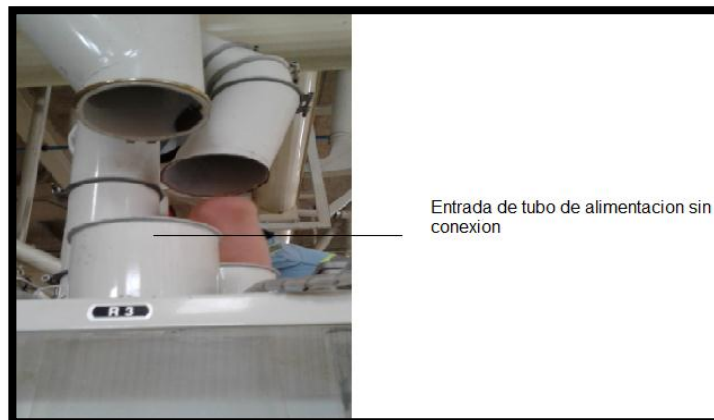
Imagen No. 3. Tubos de alimentación sin conexión
