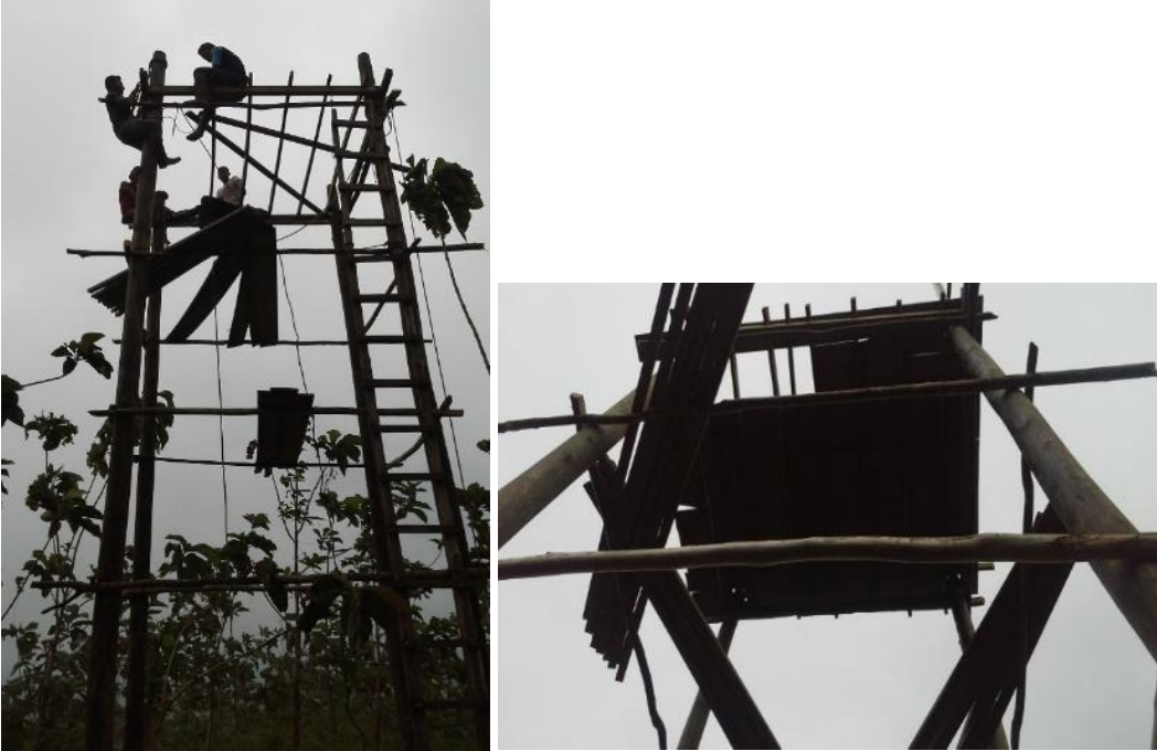
Figura 40. Fotografía de la estructura final de vigilancia de la torre finca El Recreo.
