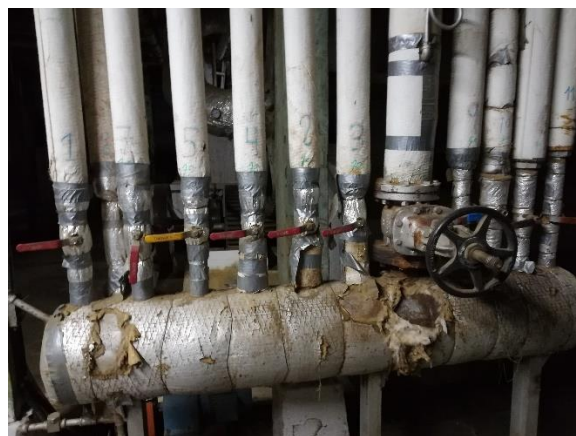
Figura 91. Daño en válvulas de vapor
