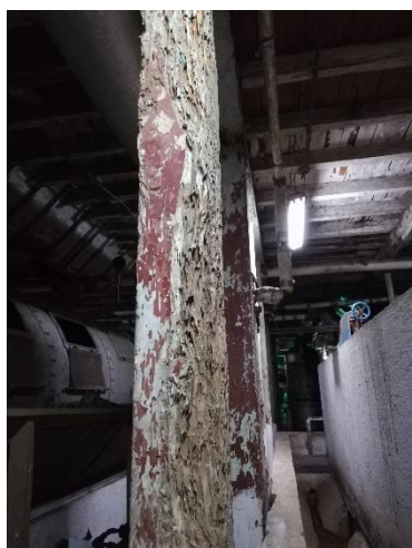
Figura 90. Daño en infraestructura
