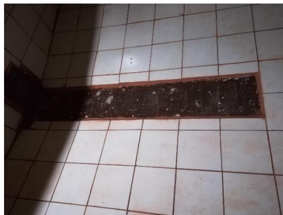
Figura 93. Falta de limpieza de rejillas
