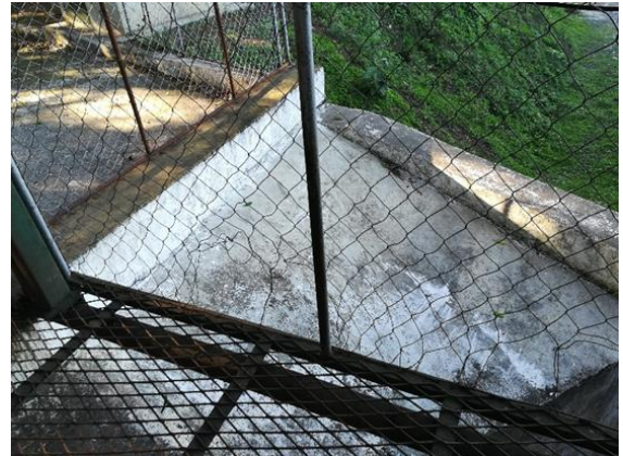
Figura 85. Daño área de pesa
