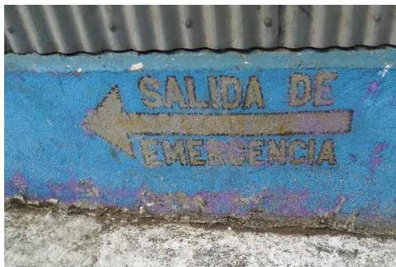
Figura 97. Deterioro en rutas de emergencia
