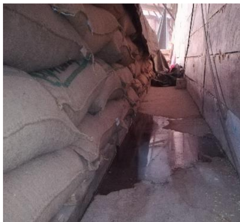
Figura 100. Filtración de agua en la bodega de café de exportación
