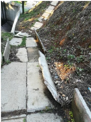
Figura 86. Erosión de muros
