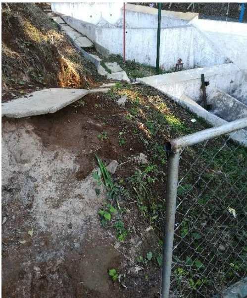
Figura 84. Deficiencia en medidas de seguridad
