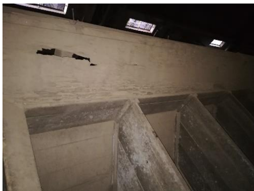
Figura 95. Daño en infraestructura
