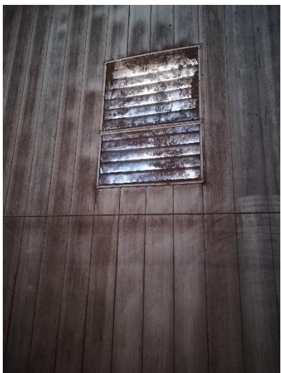
Figura 92. Falta de limpieza
