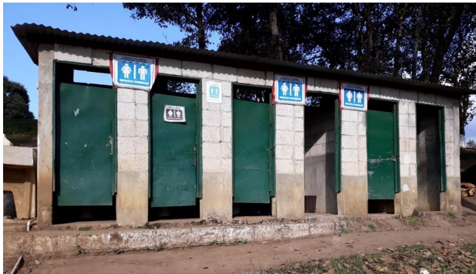
Figura 5. La infraestructura de los servicios sanitarios, como modelo descriptivo de la finca Las Gemelas.
