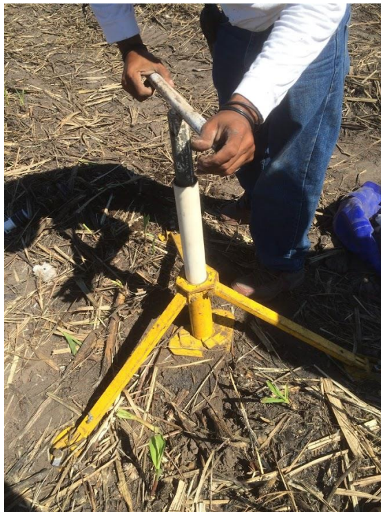
Figura 117. Instalación de tubo para monitoreo de humedad en punto priorizado de finca
