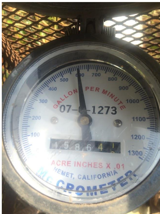
Figura 130. Hidrómetro utilizado para medición de flujo de agua
