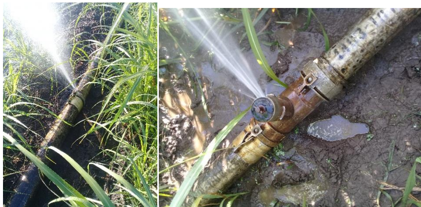
Figura 35. Fugas de agua en tuberías y accesorios.
