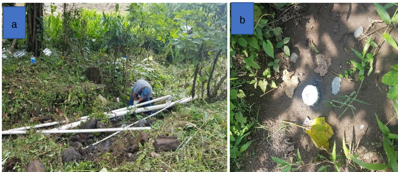
Figura 26A. Tubería conductora de agua comunidad Buena Vista II (a) y El Esfuerzo (b).
