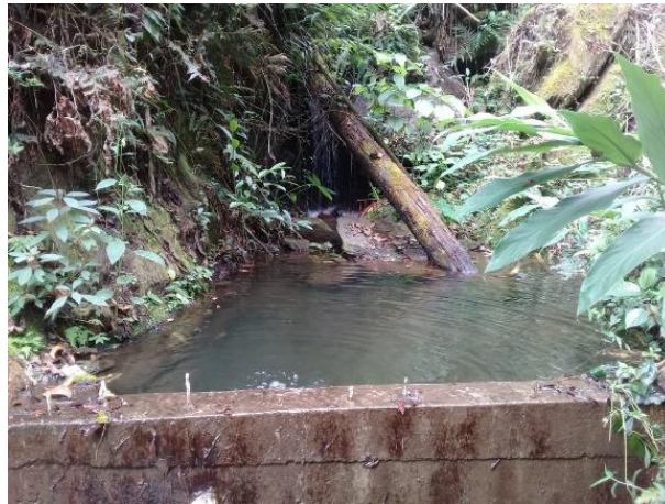
Figura 5. Tanque de captación de agua en riachuelo “El Castellano” en sector “A”.
