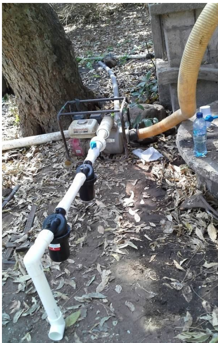
Figura 35. Sistema de bombeo y descarga para la conducción de agua del pozo a la parcela bajo riego.
