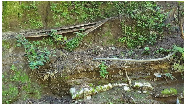
Figura 35. Captación de nacimiento para sistema de riego.
