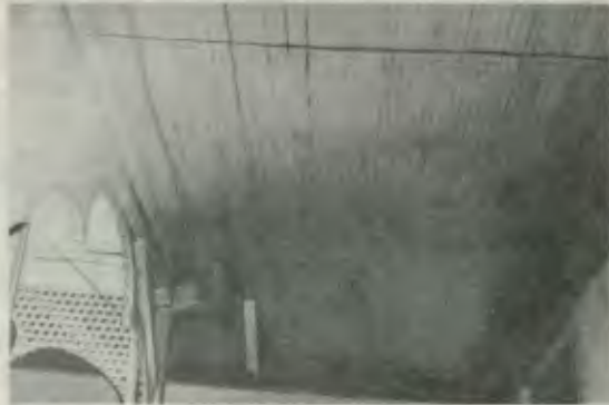
CIELO SUSPENDIDO E INSTALACIONES 1er. CUERPO
