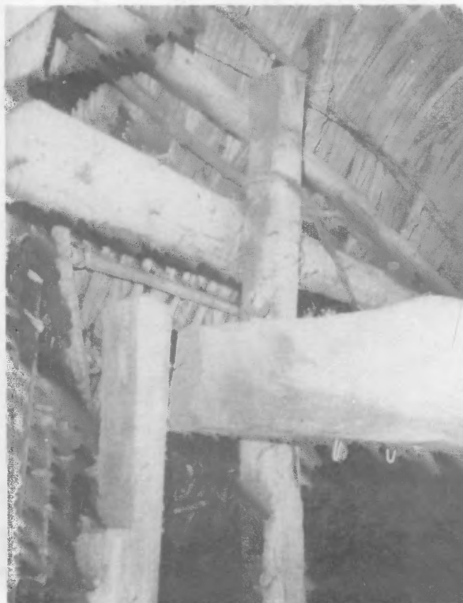
Foto No.22. Vivienda tipo 8. Estructura de techo, a base de elementos de madera rolliza. Las piezas van amarradas con tiras de bejuco.
