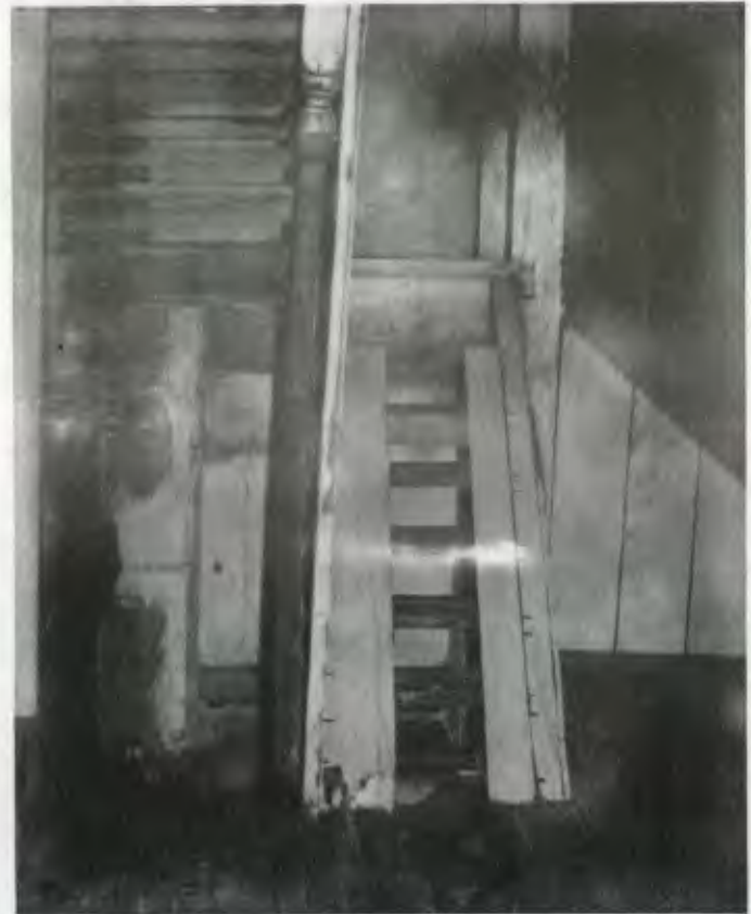
No. 6 Módulo de gradas. Apreciarse el grado de deterioro.
