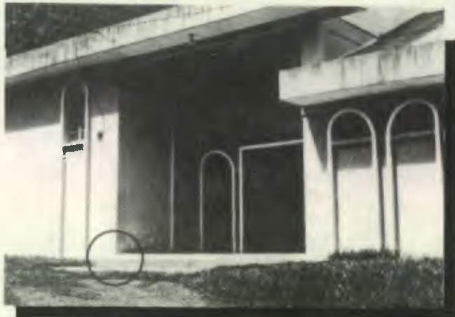
EXISTENCIA DE BARRERAS ARQUITECTÓNICAS
