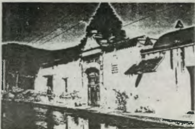
FOTO No. FACHADA PRINCIPAL. Luego del terremoto de 1,976 tomada del archivo de CNPAG, febrero 1976. Se puede notar en el extremo izquierdo, los restos del muro principal de fachada.
