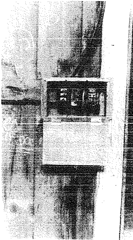
Fotografía No. 62. Detalle del tablero de distribución.
