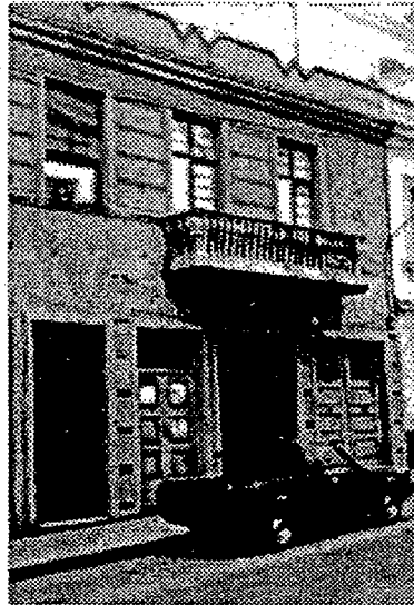
CASA EN DETERIORO
