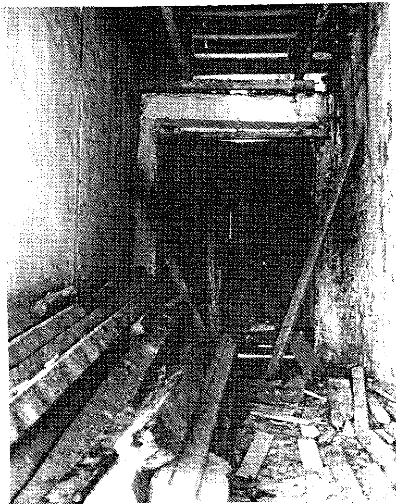
Notese el grado de avandono de esta área del convento
