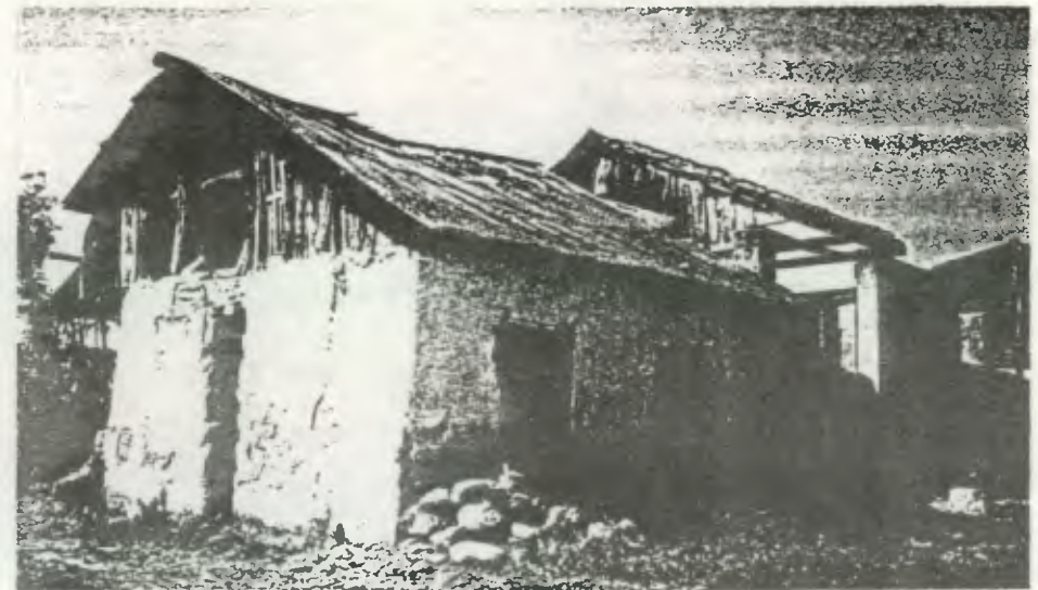
Casa perteneciente a la Finca El Recreo, abandonada y en estado pésimo. Utilizada por el caporal, donde la parte principal ya desapareció.
