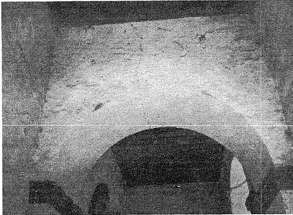
FOTOGRAFÍA No. 22 VISTA DE LOS ARCOS INTERIORES, PRESENCIA DE GRIETAS DEBIDO A LOS SISMOS (CAUSA EXTRINSECA NATURAL)
