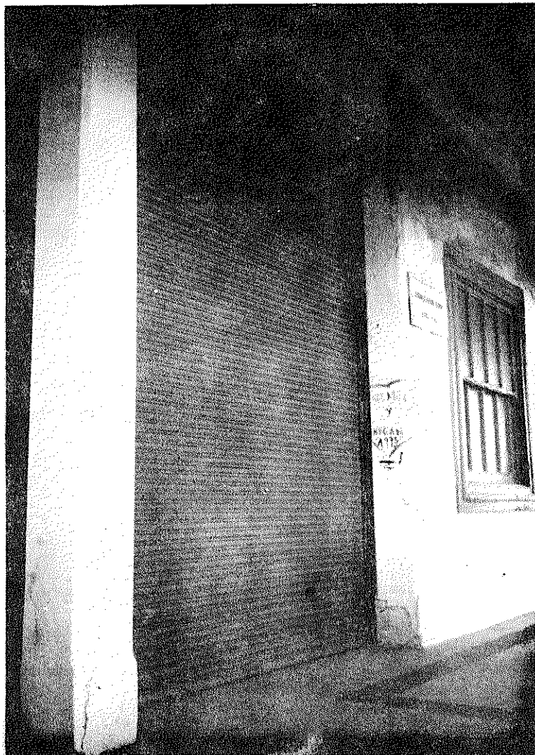
• DAÑOS POR GRAFITTI Y BRISA MARINA
