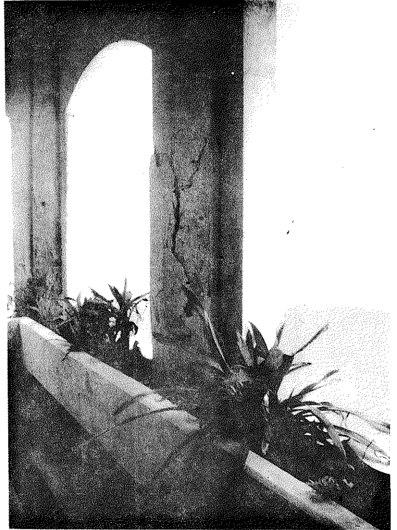
• JARDINERA Y COLUMNAS PRESENTAN DESPRENDIMIENTOS
